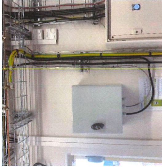
Coffret électrique et télécom
